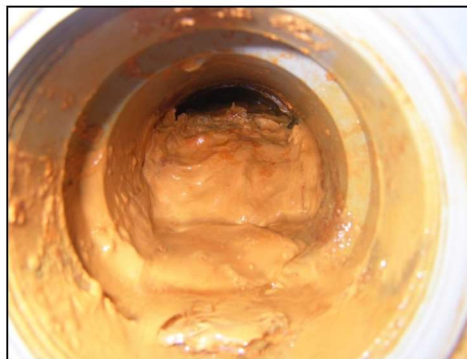
酸化化合物(スケール)による目詰り
