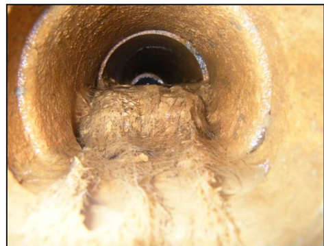
木根による目詰り
